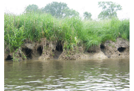
Dégâts sur berge
